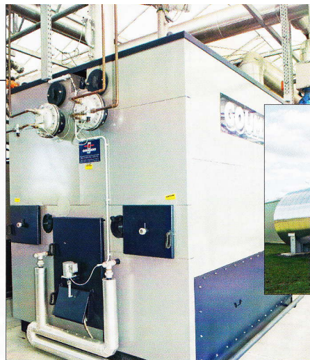
Den Wärmebedarf deckt eine Anthrazitheizung
